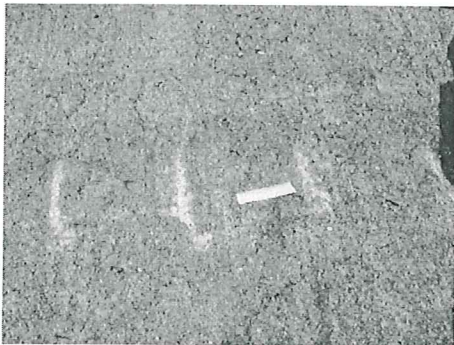
Huellas dejadas por las hélices sobre la superficie de la pista
